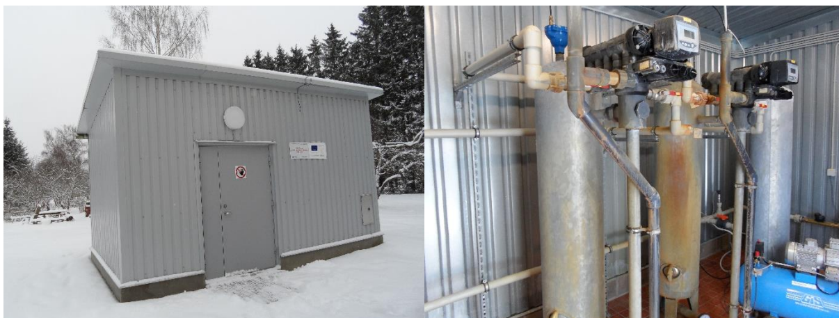
Joonis 5.5 Võõpste puurkaevpumpila
